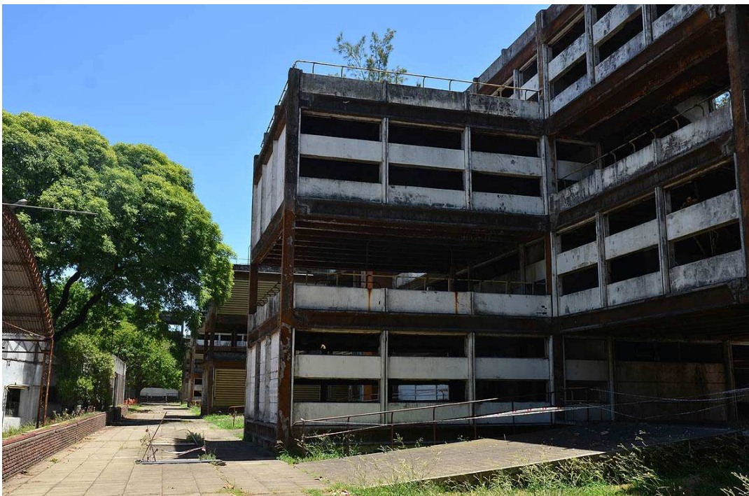
Foto 4: Detalle del deterioro en la fachada interna.
